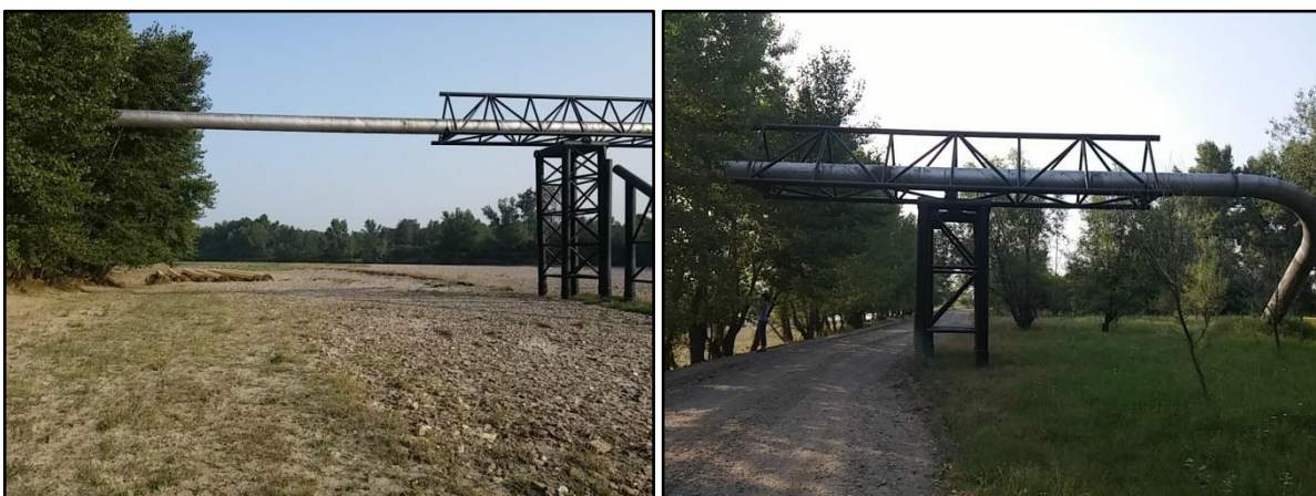
Figura 37 - Conducta existentă traversare râului Moldova coordonate N 46 57 32 859 și E 26 50 44 630, N 46 57 30 20 și E 26 50 41 34
