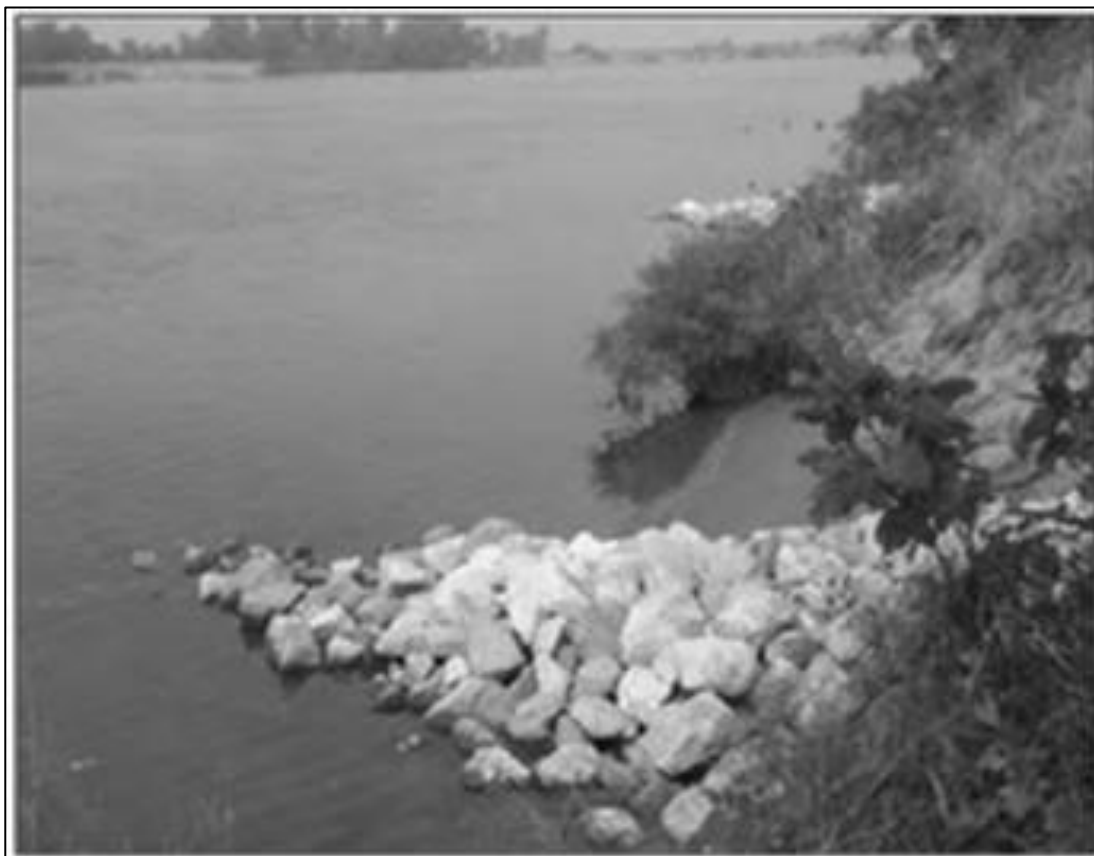
Figura 2.4-15 Epiuri pinten din arocamente, exemplu: eficient pe malul adiacent unui curent in miscare
