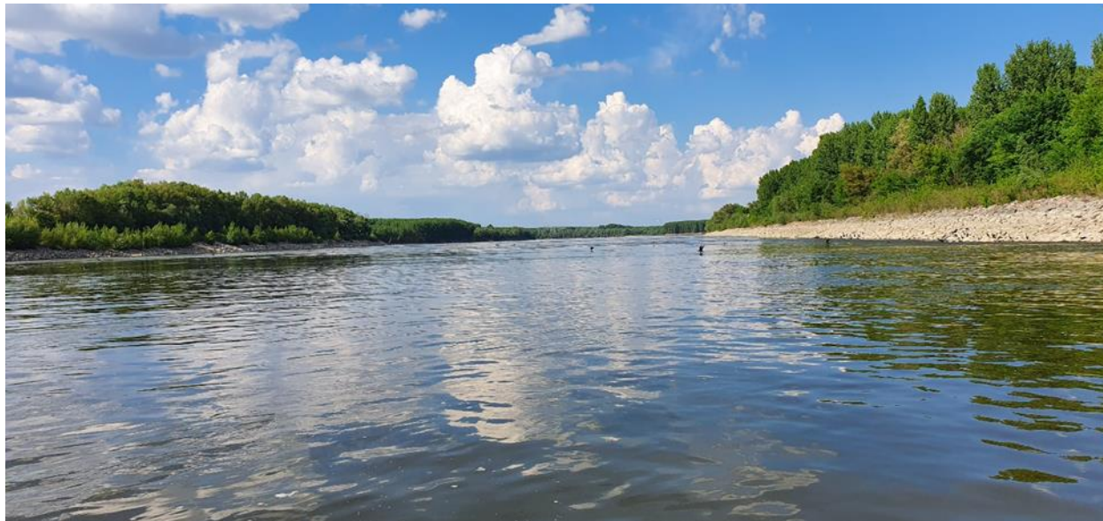
Figura 5.2-7 Aspecte ale stabilizarii malurilor realizate in cadrul proiectului "Imbunatatirea conditiilor de navigatie pe Dunare intre Calarasi si Braila si masuri complementare", pe care as-a instalat Amorpha fruticosa , pe bratul Bala, in zona km 10
