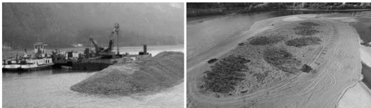
Figura 2.12-4 Construire insula, Wachau, fluviul Dunarea (sursa: Life Nature Wachau, 2008) (stanga) si construire insula, proiectul Bonners Ferry Island (sursa: Lower Meander Project Design Report, RDG 2017) (dreapta)
