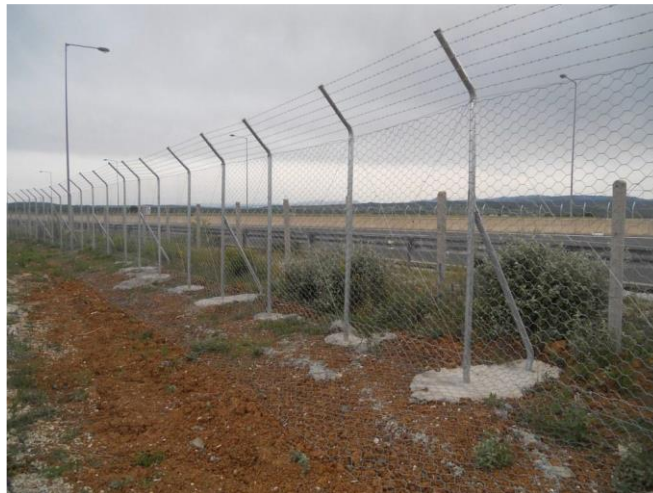
Figura 4.10. Împrejmuire pentru limitarea accesului pe autostrada a speciilor de carnivore mari și mamifere
