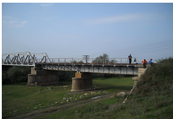
Figura 51. Pod de cale ferată ce traversează râul Barcău în cadrul ROSPA0067 Lunca Barcăului
