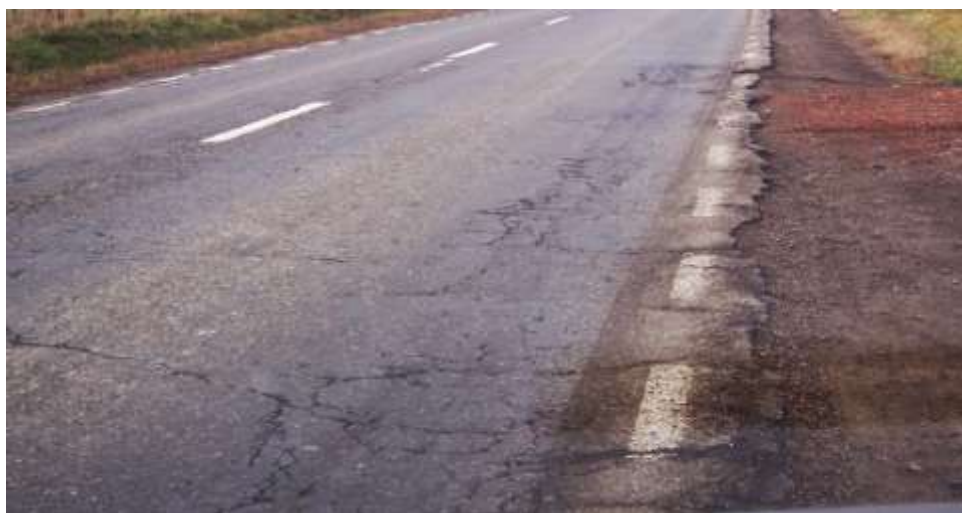
Km 2+800 Făgaș longitudinal cu faianțare și fisuri/crăpături transversale dese
