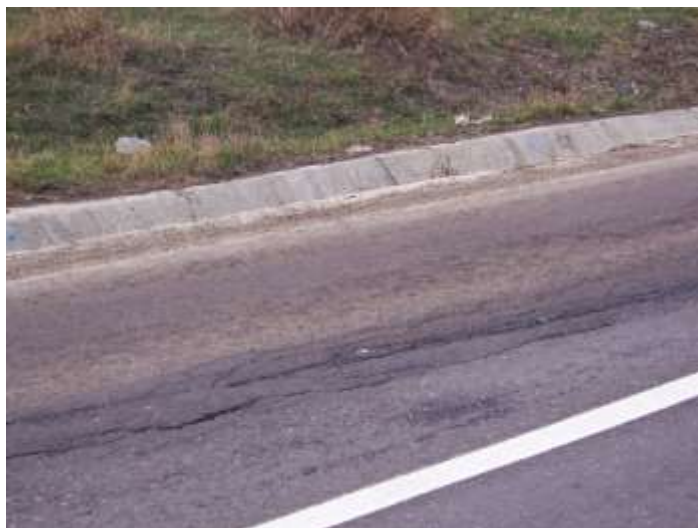
Km 36+500 Crapatura longitudinala pe făgaș
