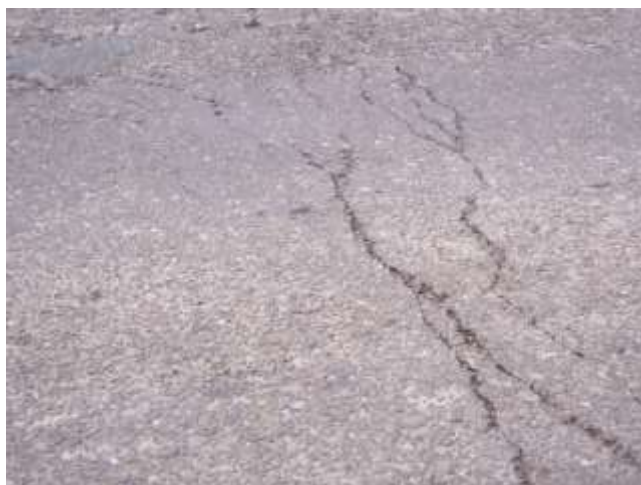
Km 2+700 Fisuri și crăpături transversale care se ramifica în fisuri pe direcții multiple
