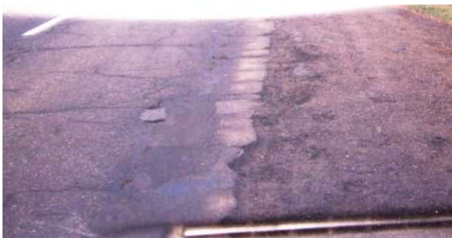
Km 58+500 Numeroase fisuri / crăpături transversale și longitudinale Făgaș longitudinal Este imagine caracteristica sectorului km 57+600 – 59+000
