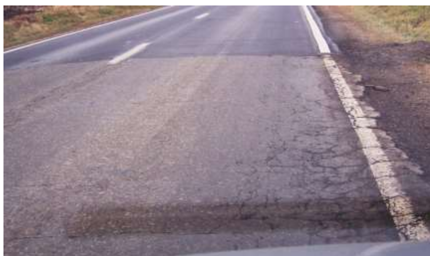
Km 2+950 Sfarsitul fagasului cu faianțare. În axa drumului se observa o fasie cu stratul de uzura degradat.
