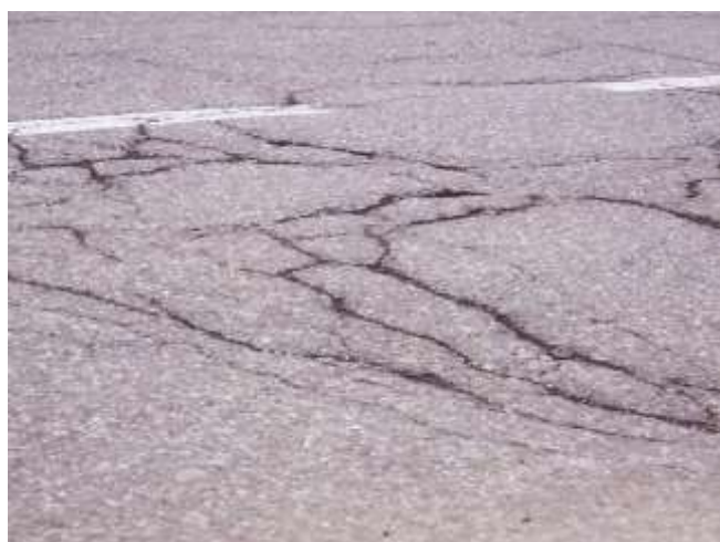
Km 37+300 Fisuri/crăpături în directii multiple pe intreaga suprafata a partii carosabile
