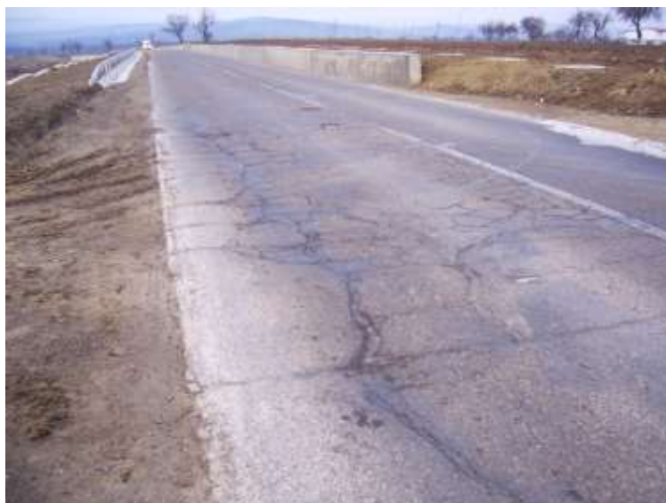
Zona km 64 Stratul de uzura complet degradat. Stratul este așternut pe beton de ciment
