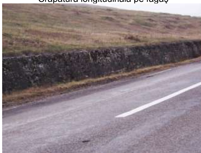
36+800 Făgaș longitudinal cu refulare spre margine
