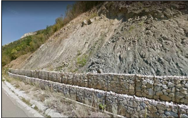
km 62+300 – zid din gabioane și ravene
