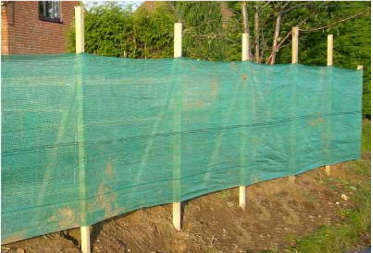
Figură 87 Model de structură de delimitare a zonelor de șantier cu ajutorul materialelor textile (mesh) ce prezintă avantaje multiple (ecranare vizuală, limitare a poluării cu praf, limitare a accesului neautorizat, etc.)
