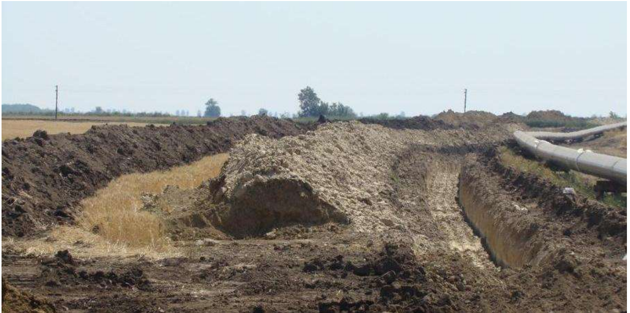
Figură 21 Aspectul unui culoar de lucru pentru amplasarea unei conducte de transport gaze naturale
