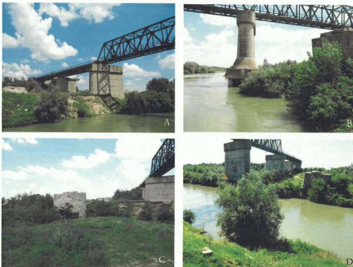
Figura nr. 2-17 - Podul actual peste râul Argeș și pilele podului prăbușit (A și C - vedere spre malul dinspre București; B și D - vedere spre malul dinspre Giurgiu)
