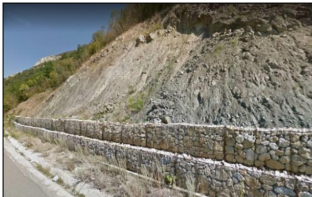
km 62+300 – zid din gabioane și ravene
