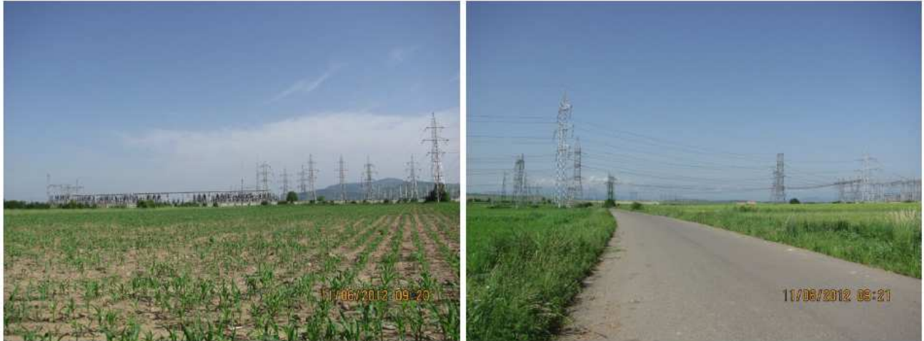
Figura nr. 1 Amplasamentul Stației de Transformare Gutinaș și celelalte LEA care ies din stație
