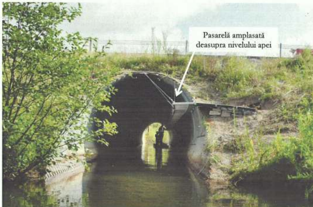
Figura nr. 5-11 Exemplu al unui podeț dotat cu pasarelă pentru deplasarea faunei
