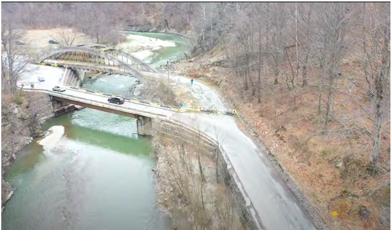
Fig. 6. Fotografie privind necesitatea construirii unui pod nou peste râul Jiu la km 105+250
