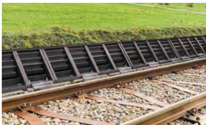
Figura nr. 2-6 Exemplu de sistem de protecție împotriva zgomotului montat pe traversă
