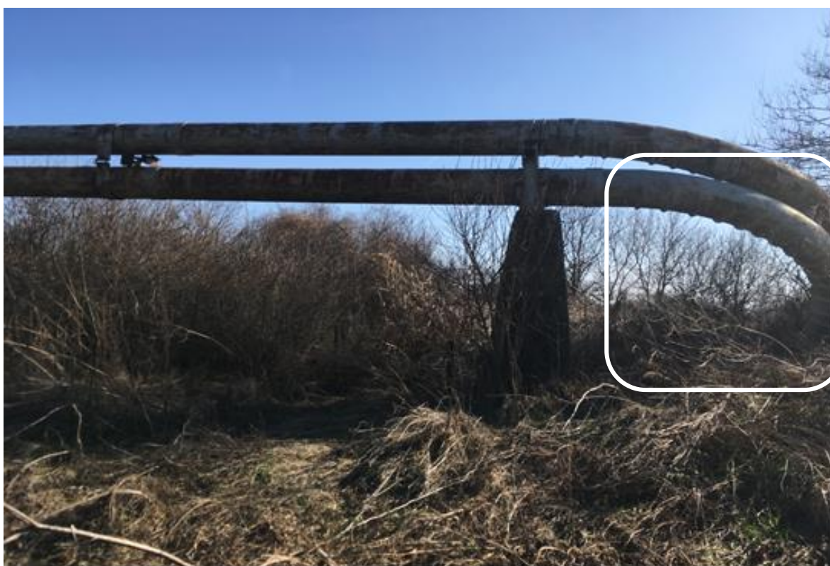
Zona execuție lucrări de reizolare conductă – circa 172 m malul stâng râul Timiș
