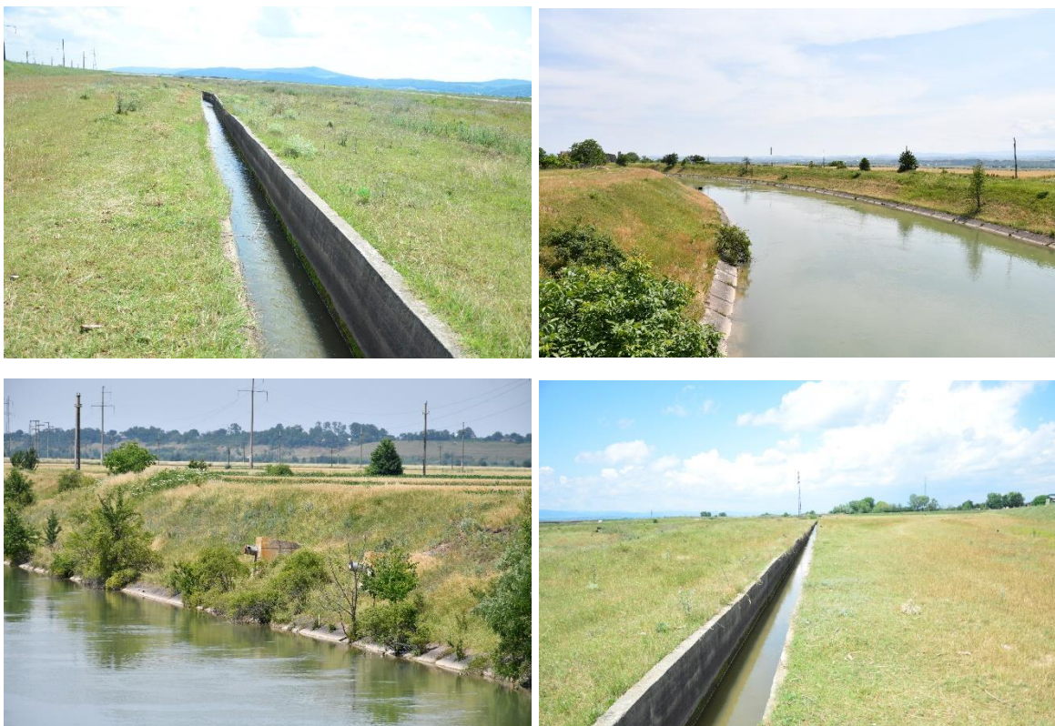
Figura nr. 3-7 Corpul de apă Canalul Piatra Neamț – Buhuși în zona de intersecție cu proiectul
