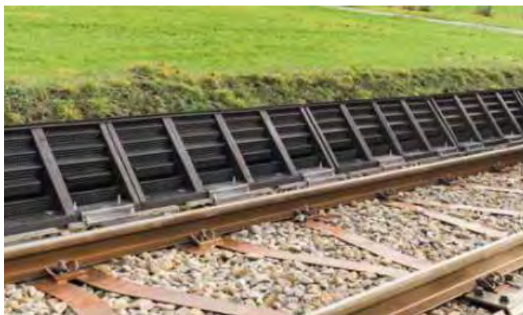
Figura nr. 2-4 Exemplu de sistem de protecție împotriva zgomotului montat pe traversă
