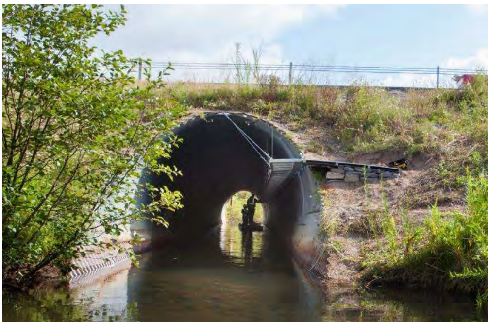
Figura nr. 5-8 Exemplu al unui podeț dotat cu pasarelă pentru deplasarea faunei
