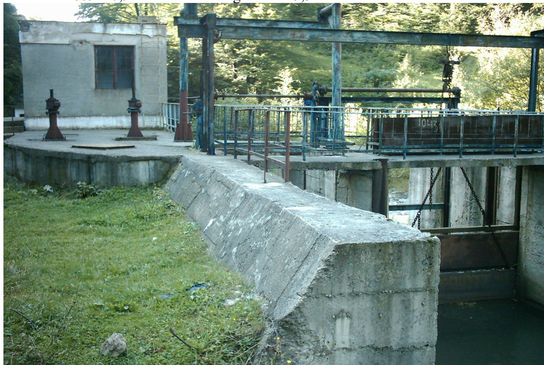
Fig 4 - Captarea de apa de pe raul Fenes
