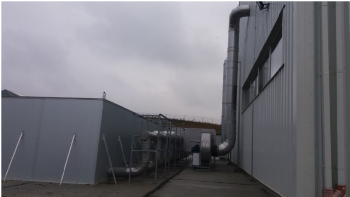
Biofiltru aferent instalației TMB
