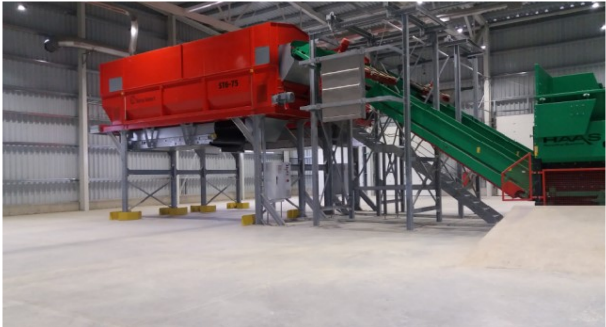
Tratarea mecanică a deșeurilor în instalația de TMB
