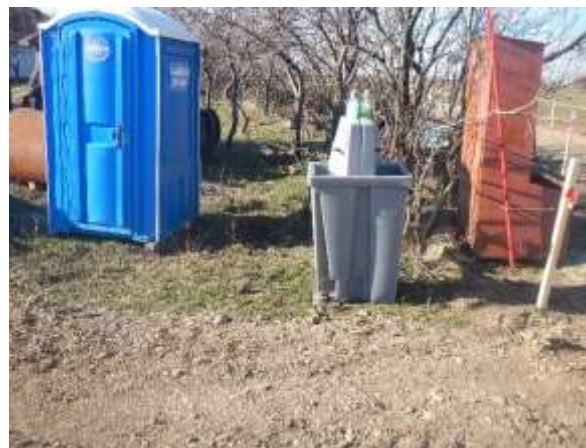
Figura 6. Sisteme modulare: toaletă individuală, chiuvetă modulară, pichet PSI
