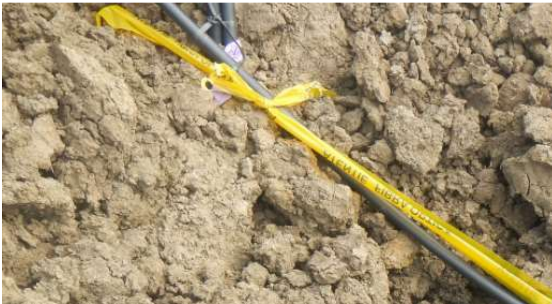
Figura 8. Model de pozare a unui cablu electric însoțit de panzica de avertizare
