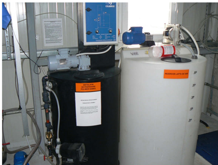
Figură 11 - Instalație de spălare gaze
