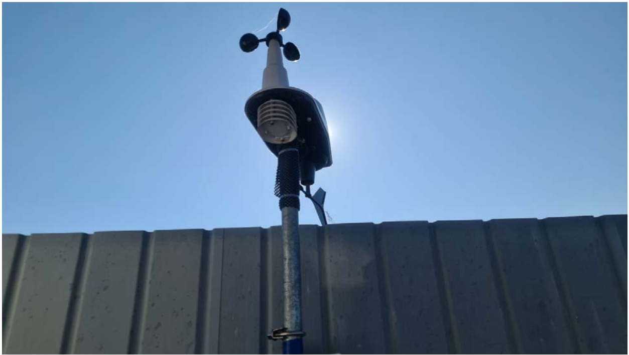
Figură 22. amplasarea stației meteorologice pe amplasamentul analizat
