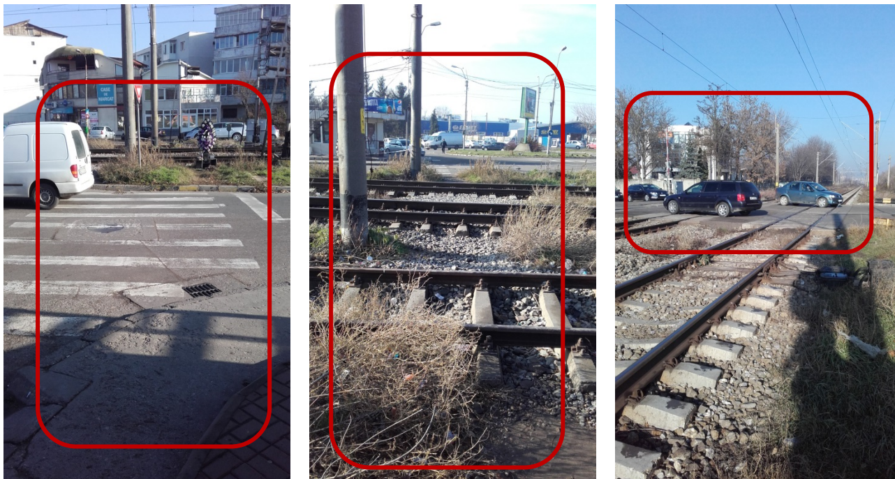
Figura 79: Trecere rutieră la nivel peste calea ferată cu trecere de pietoni amenajată inadecvat și inacceptabil Str. Alexei Tolstoi
