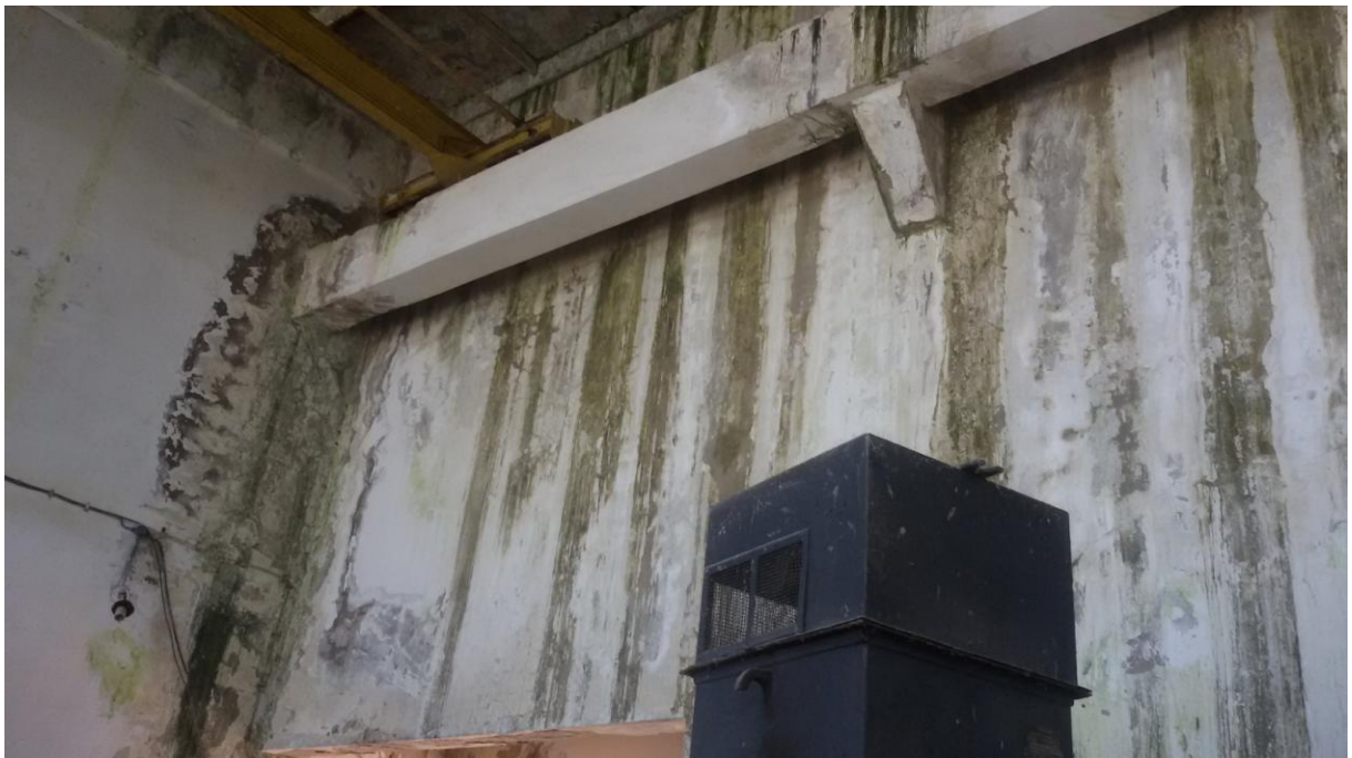
Pereți Stație de pompare – degradați
