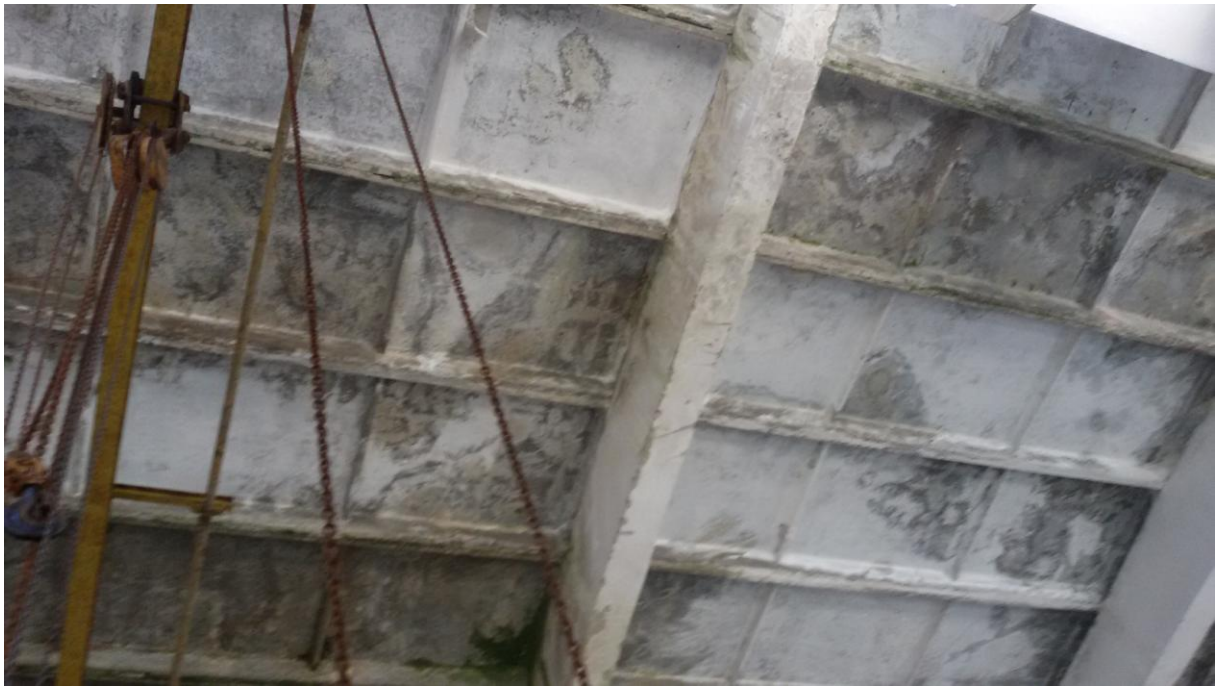
Planseu Stație de pompare - degradat
