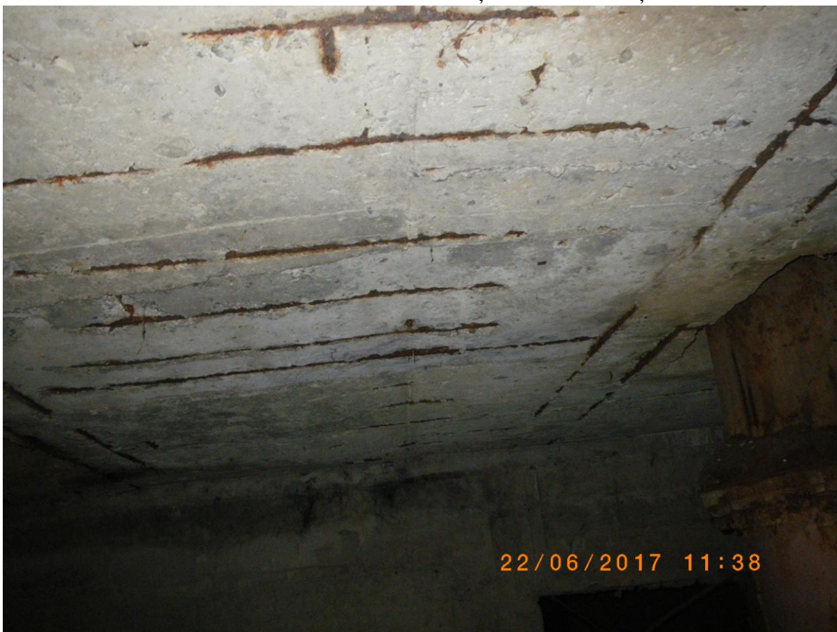
Plafonul cuvei umede – cu armatura la vedere
