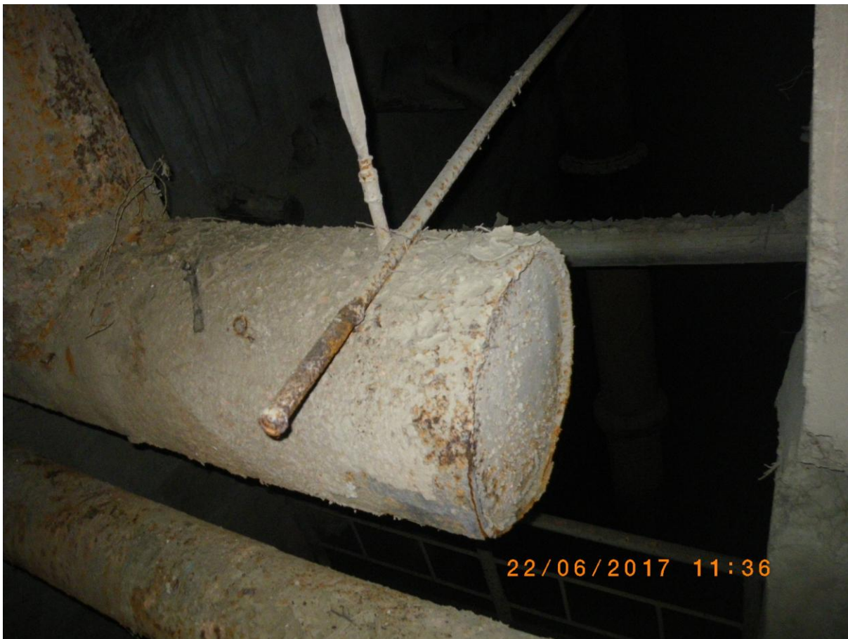
Conductă corodată interior stație SPA Dămieniști
