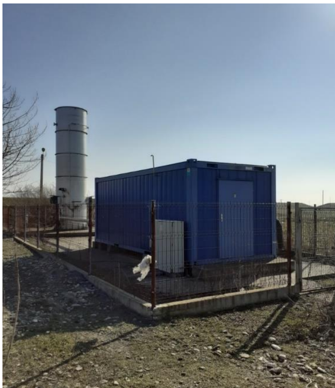
Foto. 6 Stația de ardere biogaz / gaz de depozit
