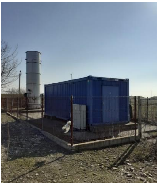
Foto. 18 Stația de ardere biogaz / gaz de depozit
