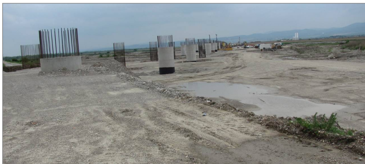
Structură pod peste râul Bistrița (zona Lacului Galbeni), în curs de construire
