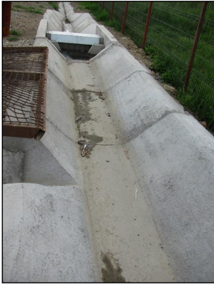
Figura nr. 15. Rigolă colectare ape uzate și decantor
