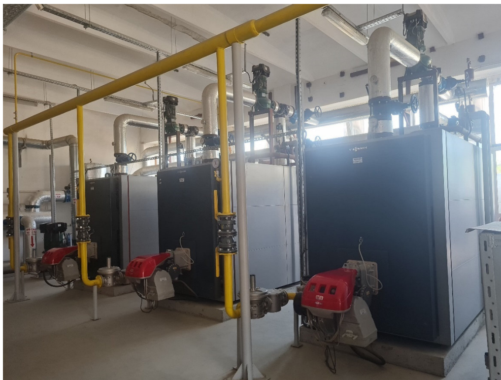
Centrala termică cu trei cazane VISSMANN VITOPLEX 200
