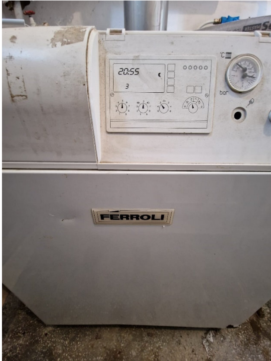
Centrala termică FERROLI cu P= 100 kW (pentru încălzirea cantinei)
