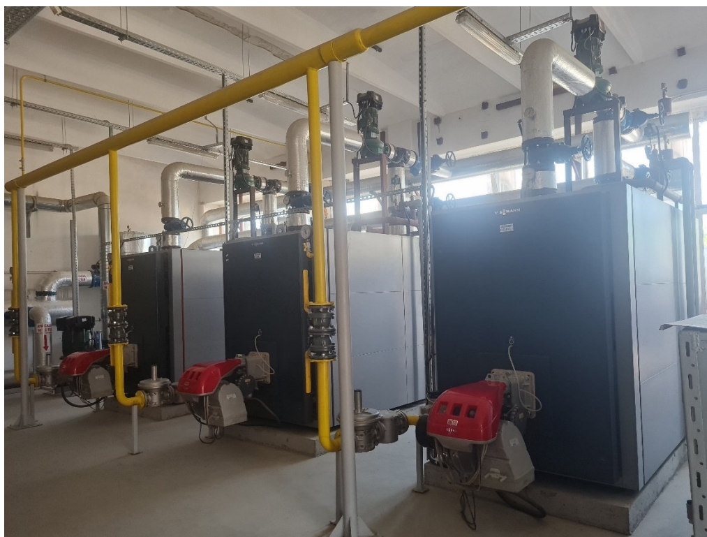
Figura nr. 5. Centrala termică cu trei cazane VISSMANN VITOPLEX 200
