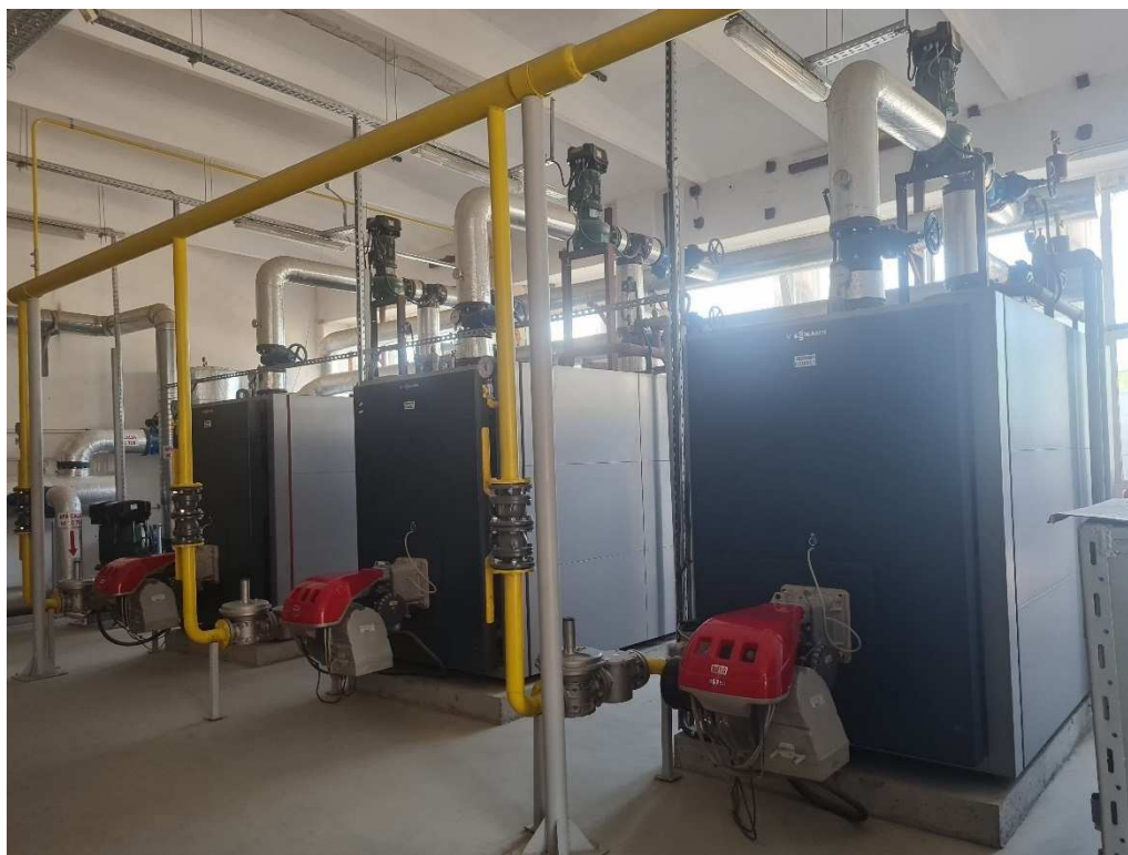
Centrala termică cu trei cazane VISSMANN VITOPLEX 200
