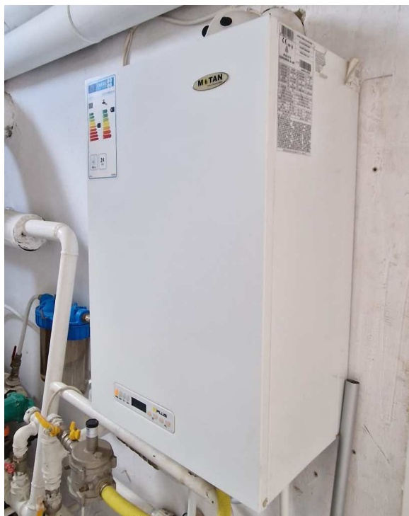
Figura nr. 7. Centrala termică murală MOTAN cu P= 24 kW (pentru asigurarea apei calde la cantină)
