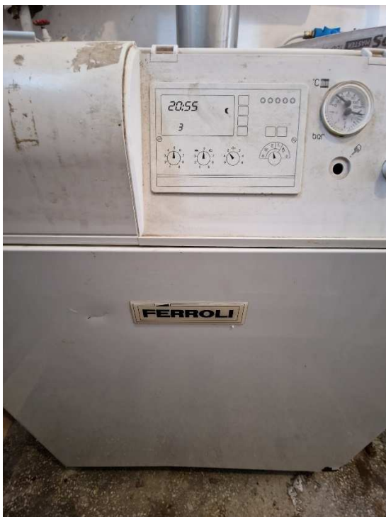
Figura nr. 6. Centrala termică FERROLI cu P= 100 kW (pentru încălzirea cantinei)
