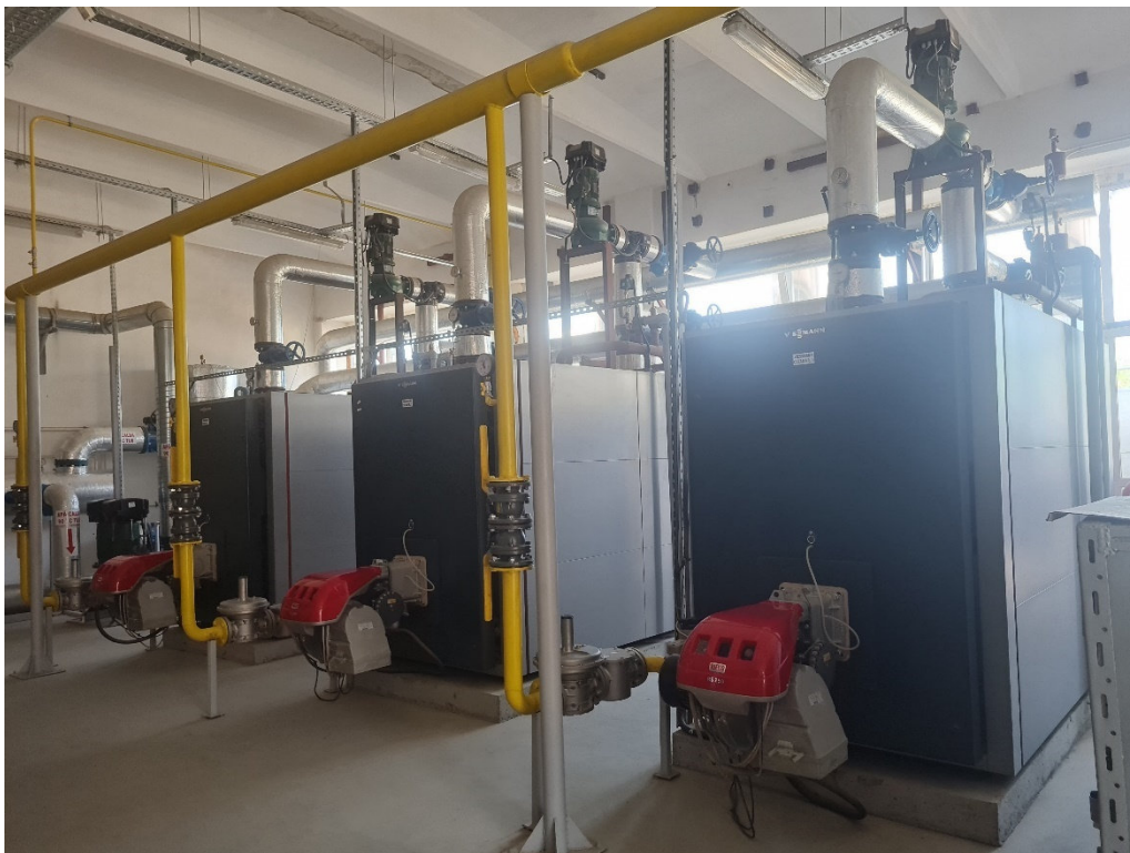
Centrala termică cu trei cazane VISSMANN VITOPLEX 200
