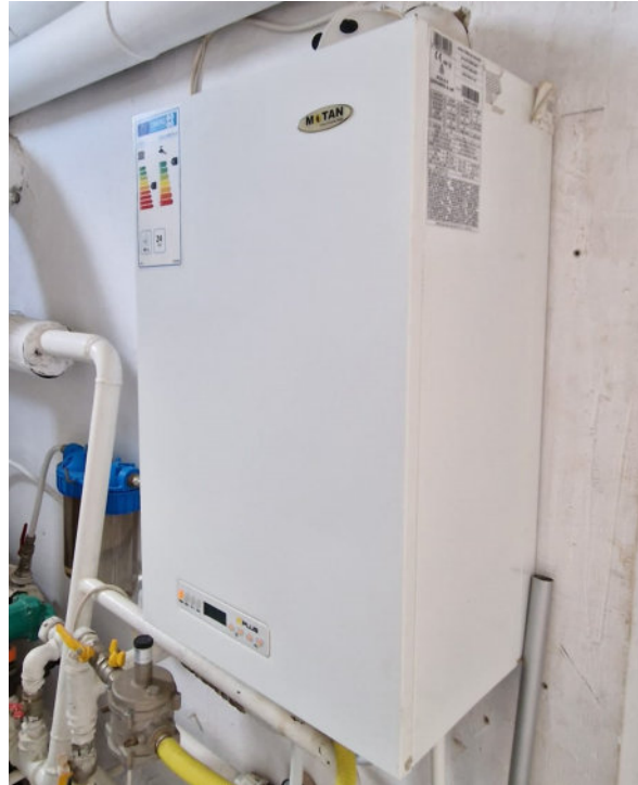
Centrala termică murală MOTAN cu P= 24 kW (pentru asigurarea apei calde la cantină)
