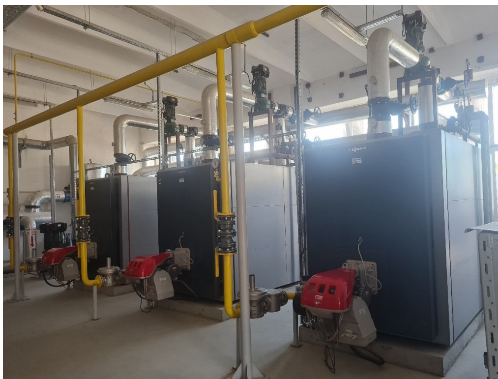
Figura nr. 5. Centrala termică cu trei cazane VISSMANN VITOPLEX 200
