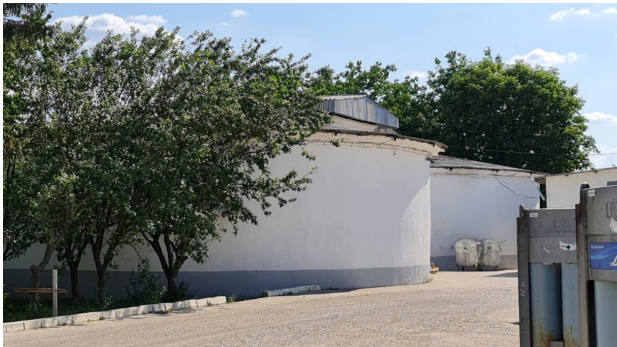
Figura nr. 13. Rezervoare de înmagazinare a apei
