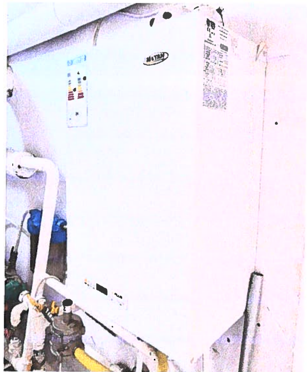
Figura nr. 9. Centrala termică murală MOTAN cu P= 24 kW (pentru asigurarea apei calde la cantină)
