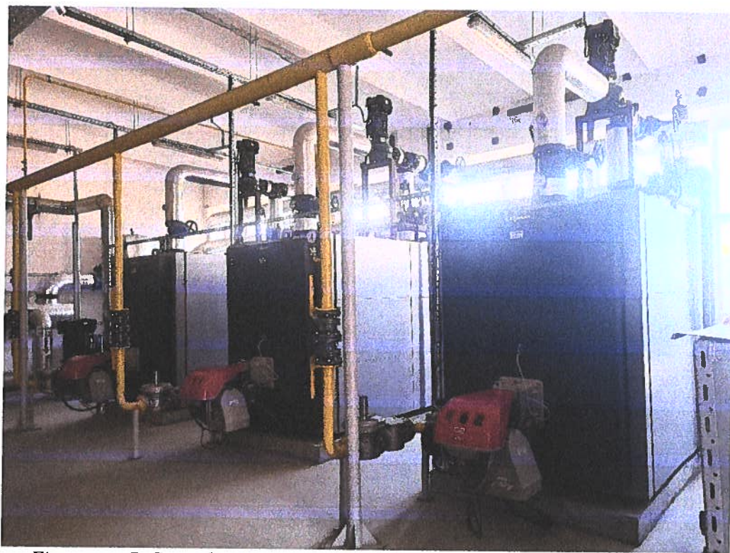
Figura nr. 7. Centrala termică cu trei cazane VISSMANN VITOPLEX 200
