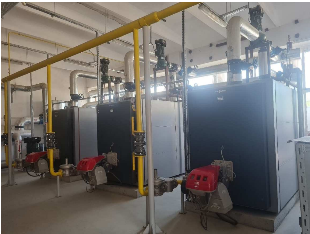
Centrala termică cu trei cazane VISSMANN VITOPLEX 200
