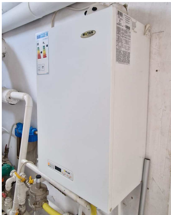
Figura nr. 7. Centrala termică murală MOTAN cu P= 24 kW (pentru asigurarea apei calde la cantină)
