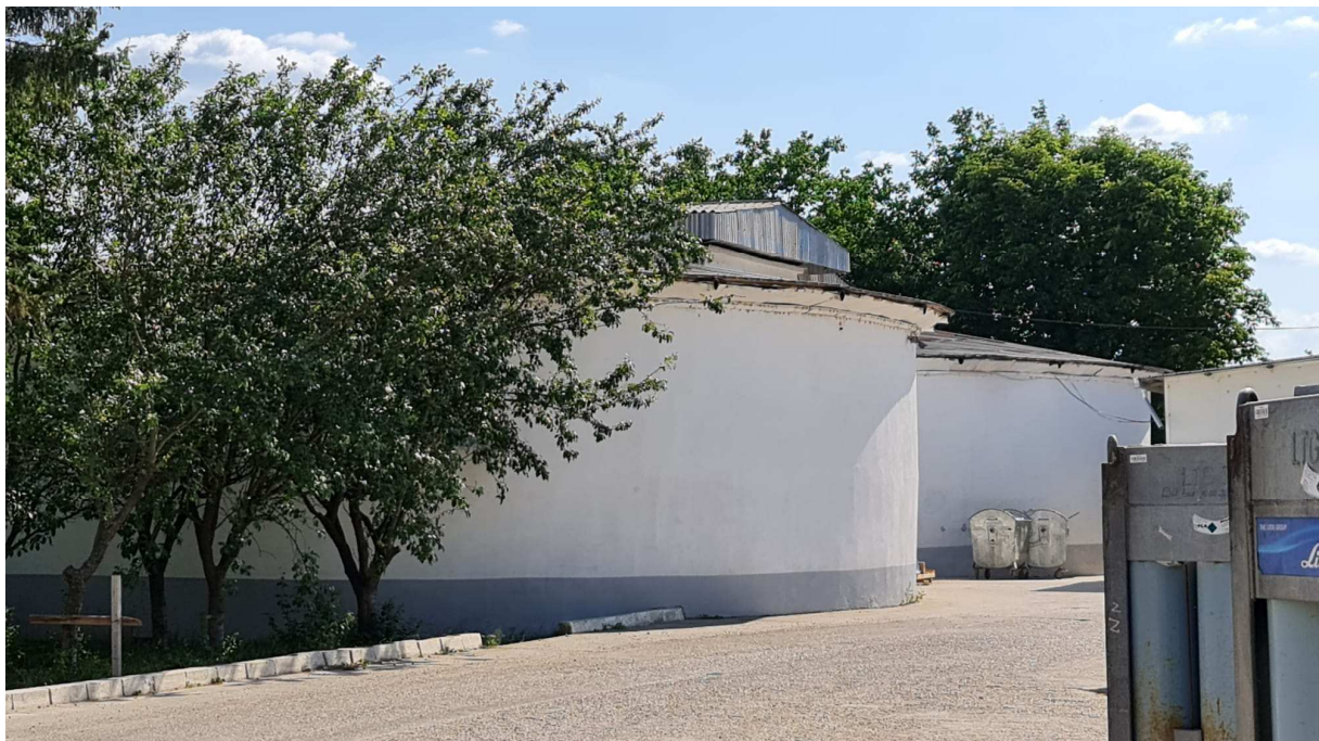
Figura nr. 13. Rezervoare de înmagazinare a apei
