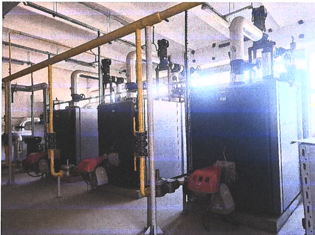
Figura nr. 8. Centrala termică cu trei cazane VISSMANN VITOPLEX 200
