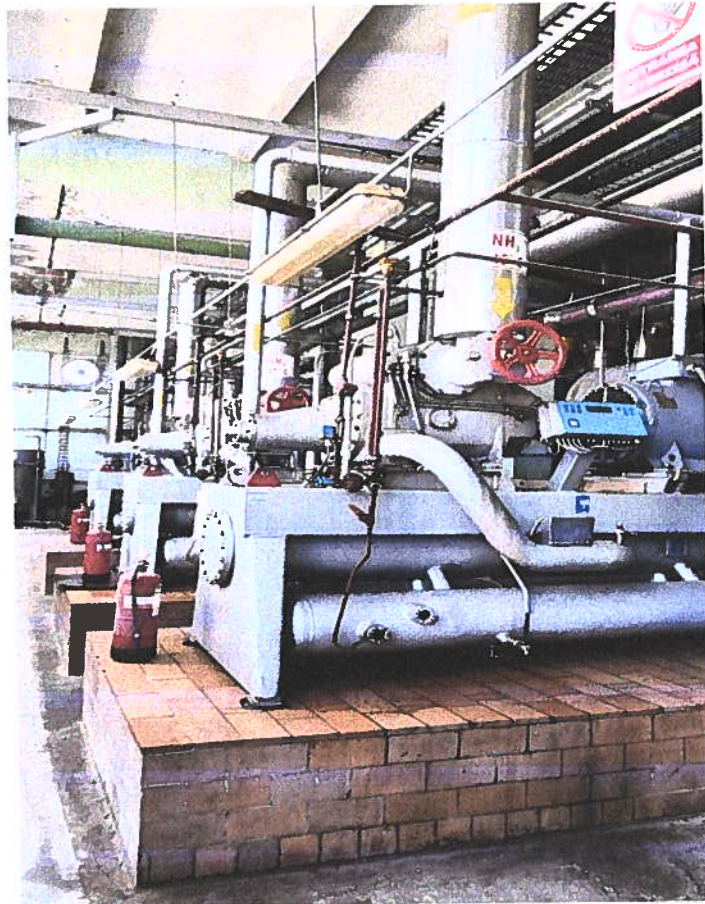
Figura nr. 13. Centrala frig
