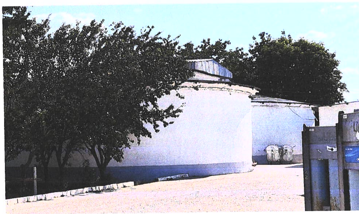
Figura nr. 7. Gospodărie de apă – rezervoare de înmagazinare
