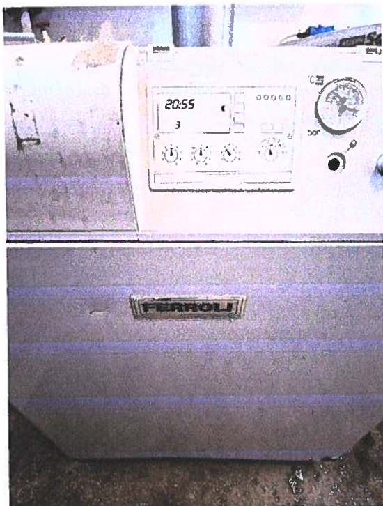
Figura nr. 10. Centrala termică FERROLI cu P=100 kW (pentru încălzirea cantinei)
