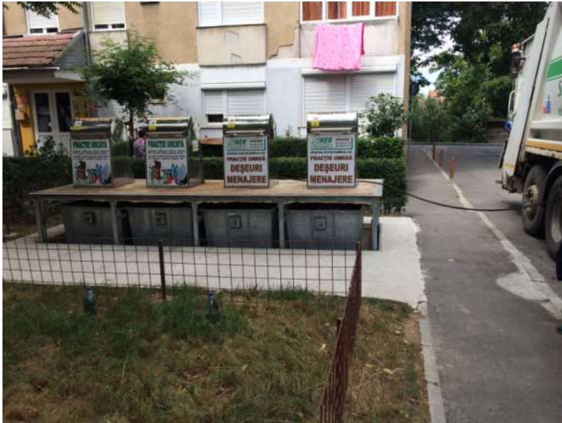
Figura nr. VII.1.1.5 Platformă subterană pentru colectarea deșeurilor menajere și a celor reciclabile – municipiul Oradea (foto: Primăria Oradea)
