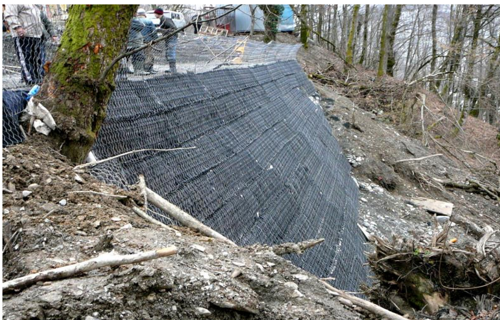
Fig. 24. Folosirea gabioanelor în mod necorespunzător.
