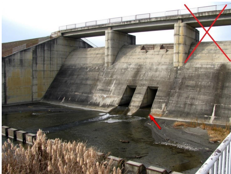
Fig. 20. Exemplu negativ: Barajul acumulării nepermanente de pe Niraj de la Valea: nu există conectivitate la nivelul talvegului, peștii nu pot să urce.
