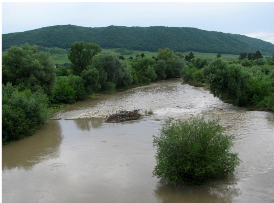
Fig. 18. Prag din beton cu scară de pești nefuncțională pe râul Bistrița în apropiere de confluența acestuia cu râul Șieu.
