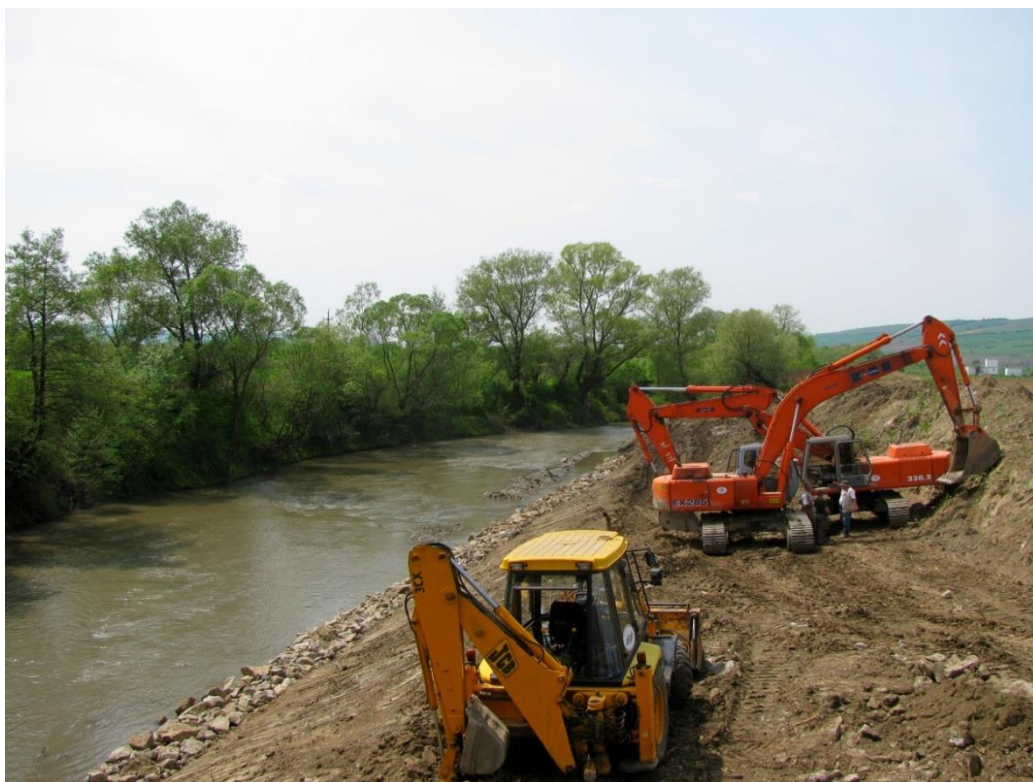
Fig. nr. 19. Lucrările trebuie efectuate în așa fel încât să nu se suprapună pe ambele maluri.
