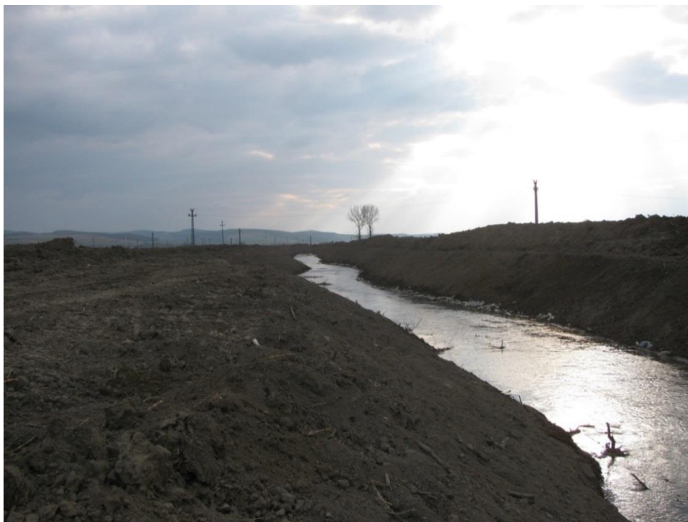
Fig. nr. 18. Efectuarea lucrărilor pe ambele maluri ale râului afectează grav biodiversitatea zonei.
