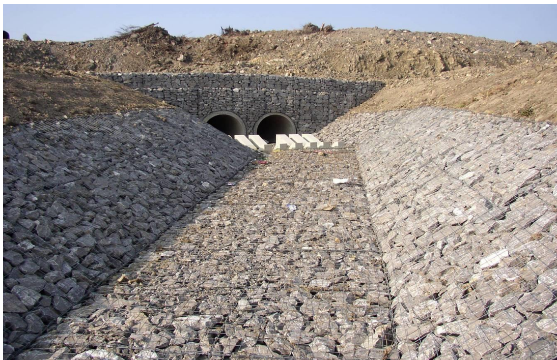
Fig. nr. 21. Pod cu gabioane nefavorabil
