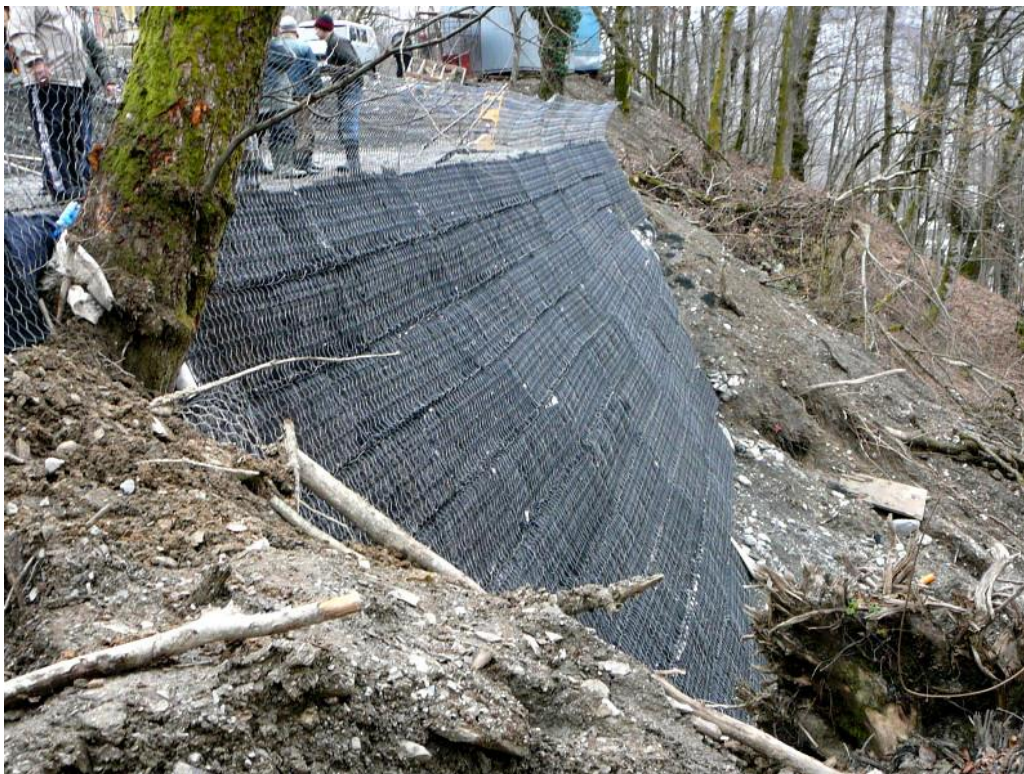
Fig. nr. 20. Folosirea gabioanelor în mod necorespunzător
