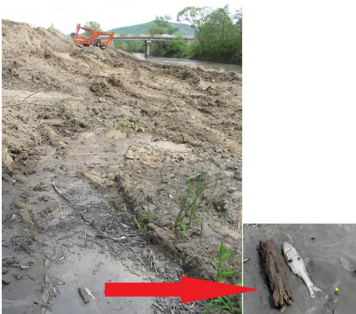
Fig. nr. 10: Pește mort din cauza decolmatărilor în timpul execuției unor lucrări de prevenire a inundațiilor.
