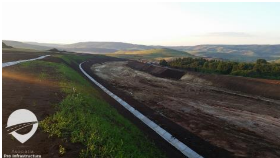
Figura nr. 4-3 Imagine din timpul lucrărilor de construcție pentru autostrada A3 Gilău-Nădășelu 12
