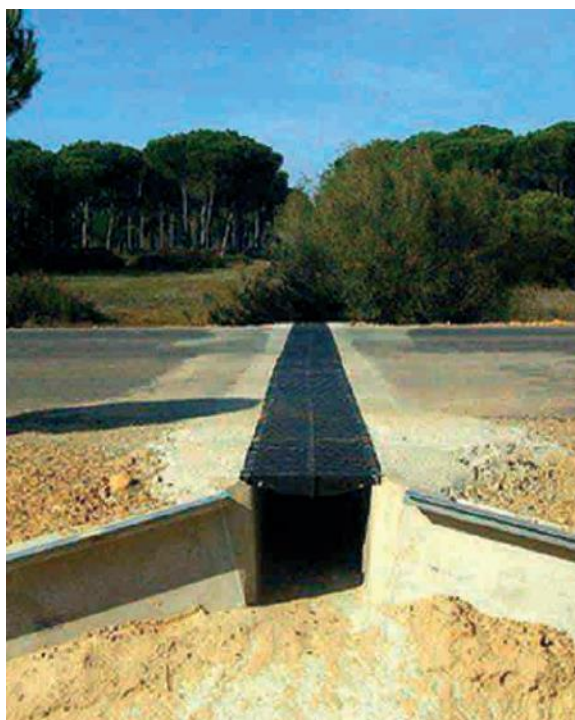
Figura nr. 8-15 Exemplu de tunel pentru amfibieni 42
