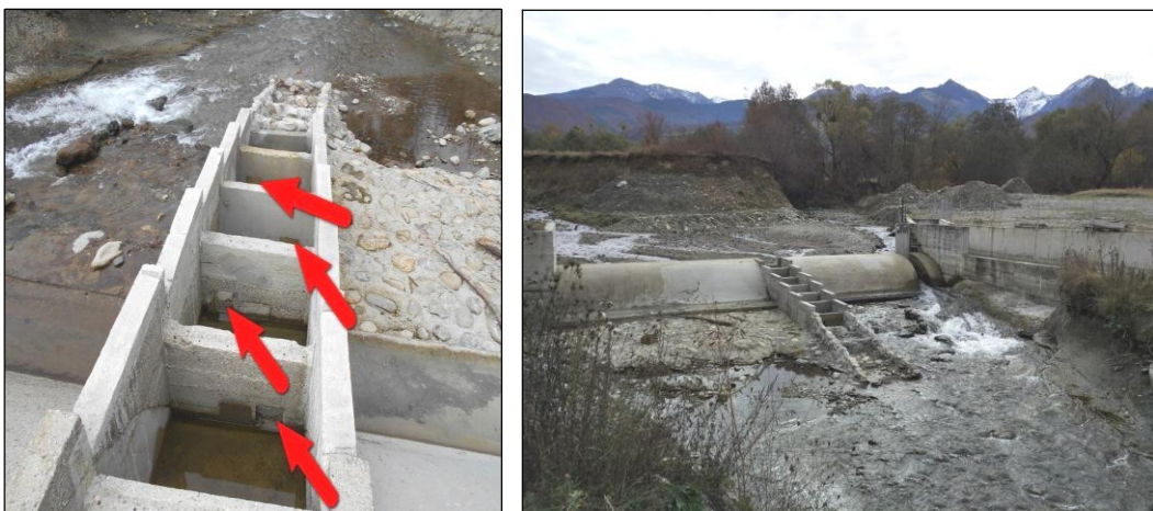
Scara de pești existentă în prezent - amplasată în mijlocul albiei minore a râului Viștea (sursa: raport monitorizare SC Eco-Logic Consulting SRL)
