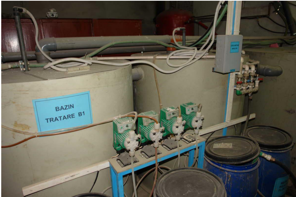
Fig. 2.3.2-11 Instalația de neutralizare
