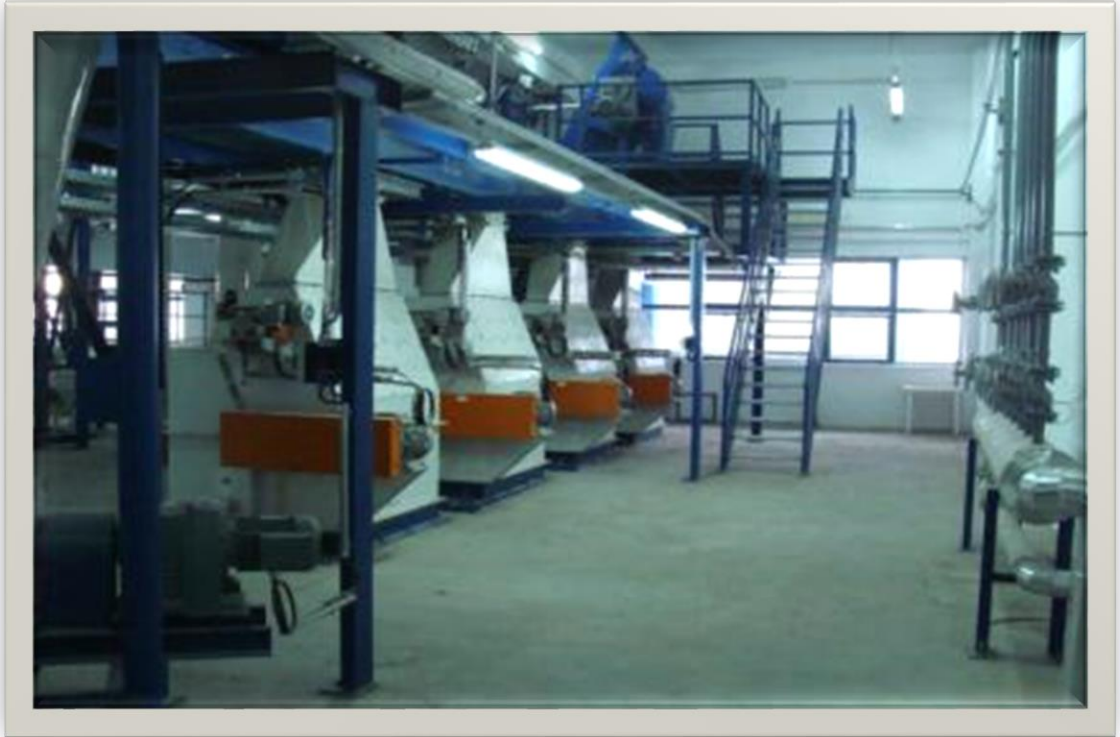
Figura 11: Instalatii crushing (general si detaliu)
