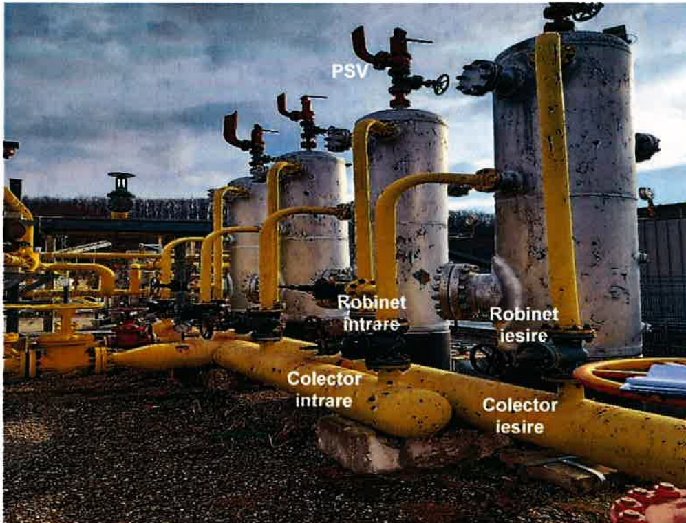
Echipamente din zona separatoarelor ce vor fi inlocuite
