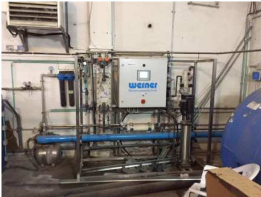
Stația de apă demineralizată Werner Wilhelm (rezervă – stand by)
