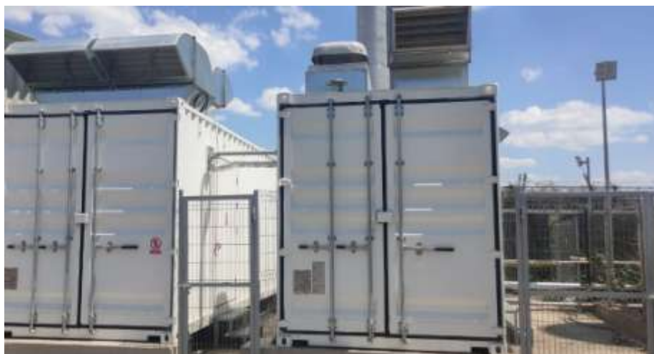
Instalația de producere azot Minigan 200
