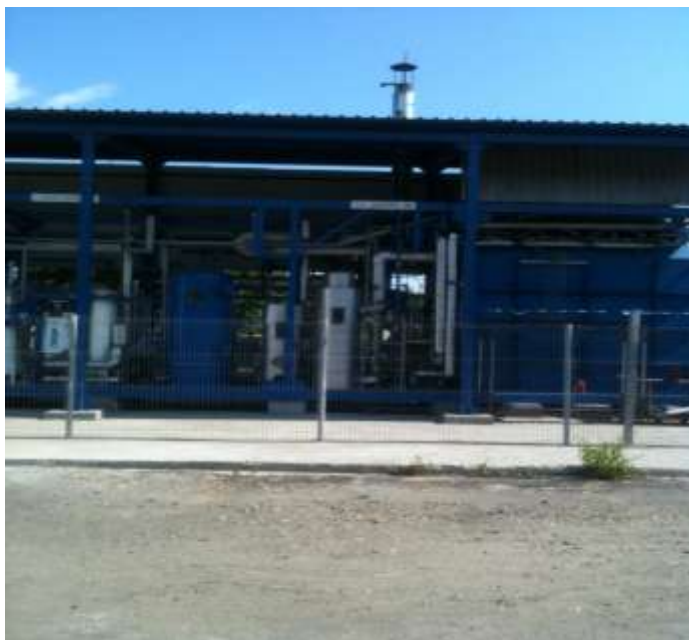
Instalația de producere hidrogen 1G
