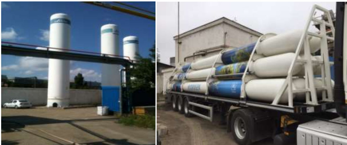
Rezervoare back-up hidrogen (3 buc. x 95 mc) existente proprietate Linde Gaz România S.R.L. închiriate de S.C. Hoeganaes Corporation Europe S.A. – Descărcare hidrogen gaz din autocisternă
