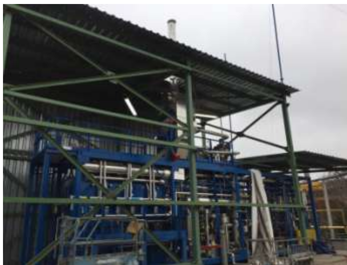
Instalația de producere hidrogen 2G
