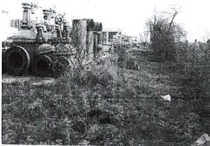
Borcea - Stație pompare Bărăganu
