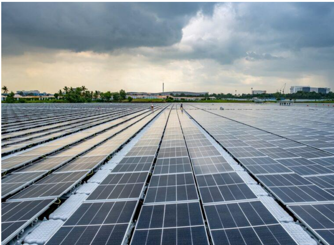
Fig. nr. 1 – Centrala fotovoltaica flotanta – vedere generala
