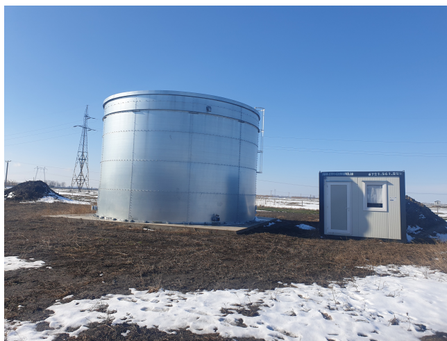
Fig. 3– Rezervor pentru inmagazinare apa si statia de pompe
